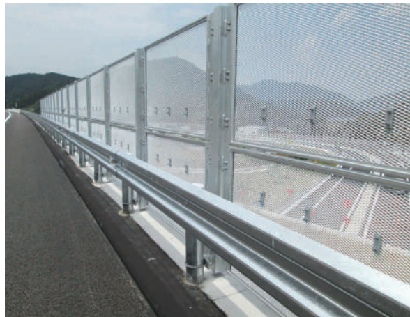
舞鶴若狭自動車道(福井県) *飛雪フェンス
