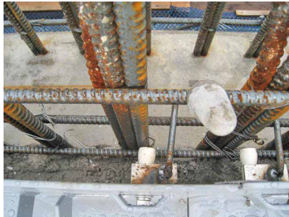
2. 位置が確定したら、アンカーバーを鋼製排水溝側の取付金具に固定します。
