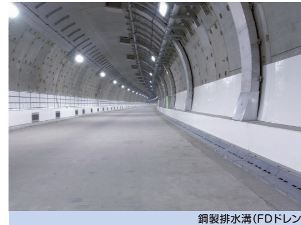
鋼製排水溝(FD dren)
