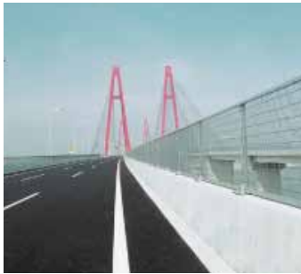
落下物防止フェンス
