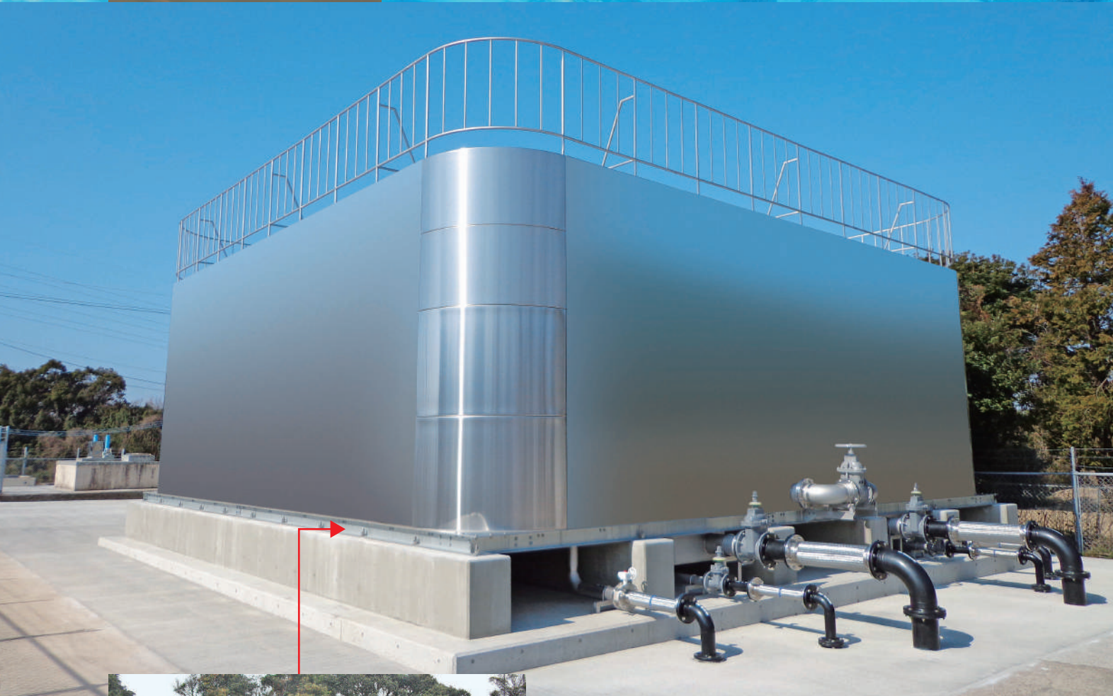
貯水タンク架台
