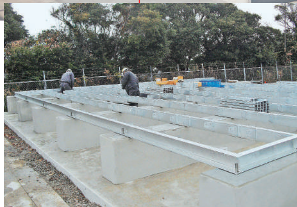
貯水タンク架台
