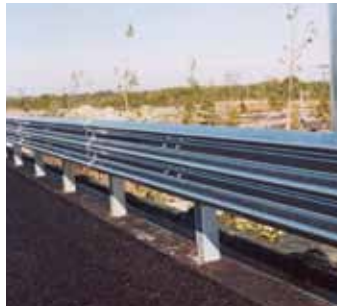
ガードレール
