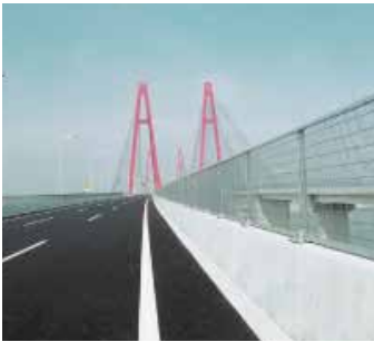
落下物防止フェンス
